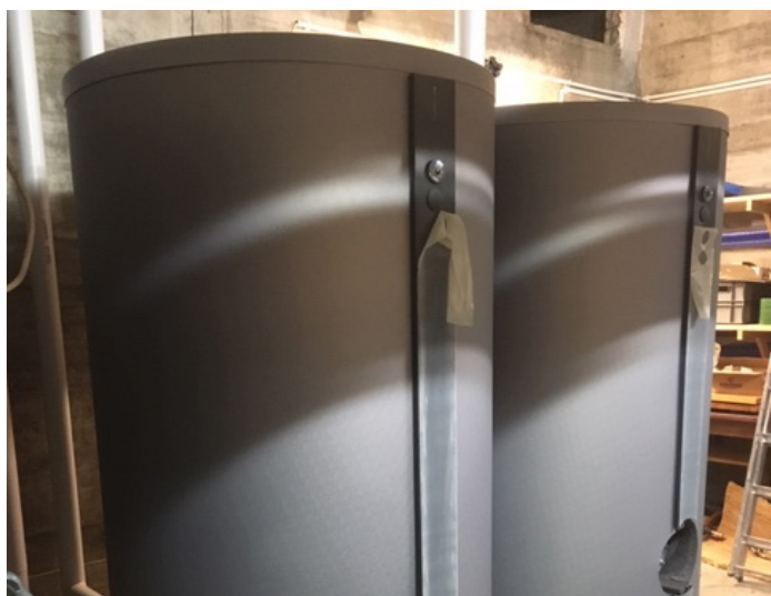
Der neue Wärmespeicher ...
